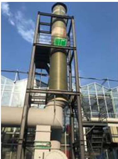
药渣处理车间排气筒标识
