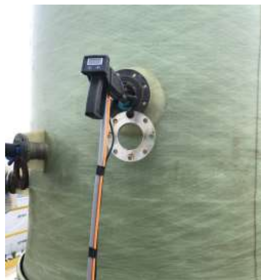
生物质锅炉烟尘出口
