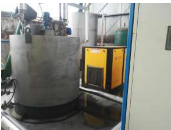
生物质锅炉脱硝系统
