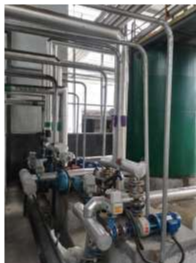
生物质锅炉脱硫系统
