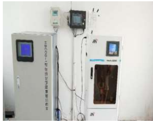
废水在线检测系统
