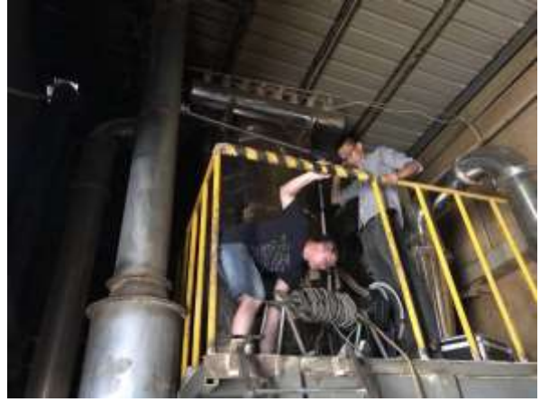
前处理车间排气筒
