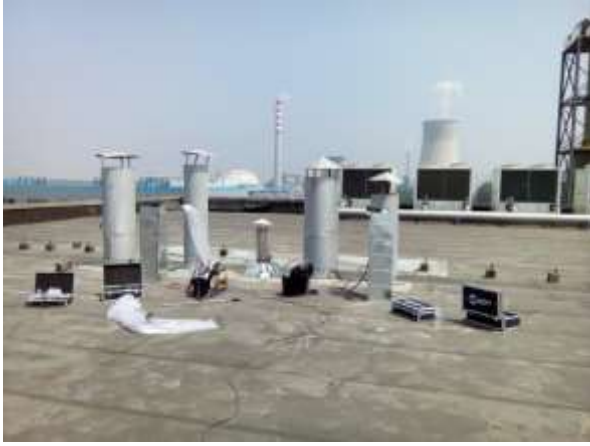
颗粒制剂车间排气筒
