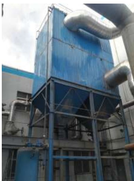
生物质锅炉 1 号布袋除尘器
