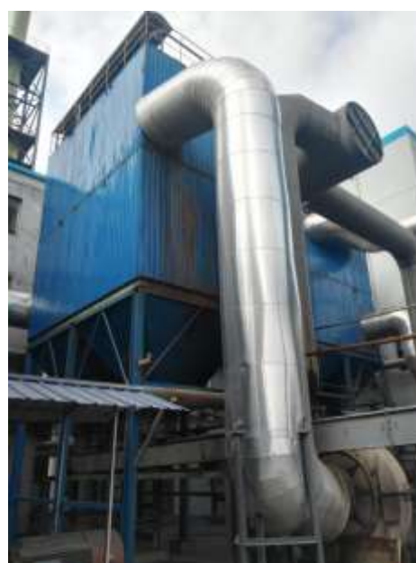
生物质锅炉 2 号布袋除尘器
