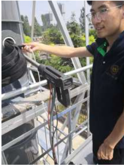
污水处理站排气筒
