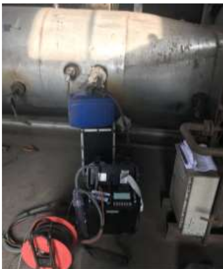
生物质锅炉烟尘进口
